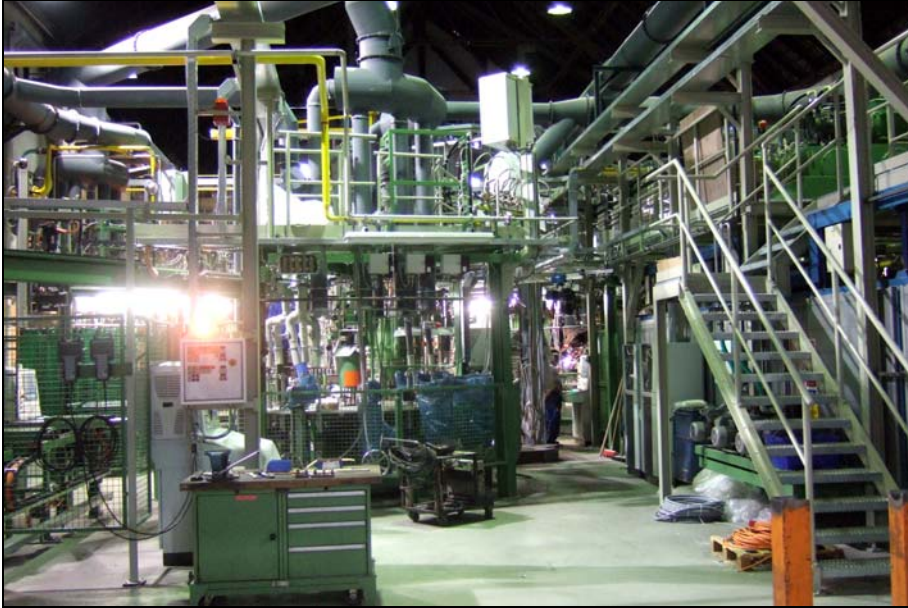
Abb. 2013-4/38-15, GLASAX: Blick in die Produktionshalle, 2008: Unter Leitungen, Kabeln und Röhren verbergen sich modernste Fertigungstechnologien für Pressglas
