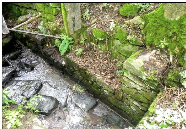
7 Smrčná, zbytky brusírny na Smrčenském potoce pod tratí Stupník. Součástí lokality je také dlouhý náhon. Foto A. Knapek 7 Smrčná, Reste der Schleiferei am Smrčná-Bach unter der Stupník-Bahntrasse. Einen Teil des Standortes bildet auch ein langer Mühlgraben. Foto A. Knapek
